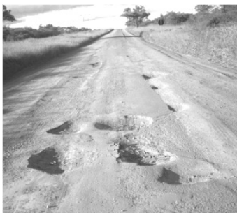
Very rough - En muy mal estado
