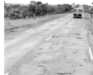
Rough - En mal estado
